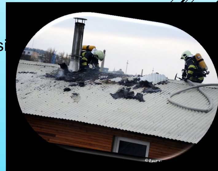
Práce po požaru
