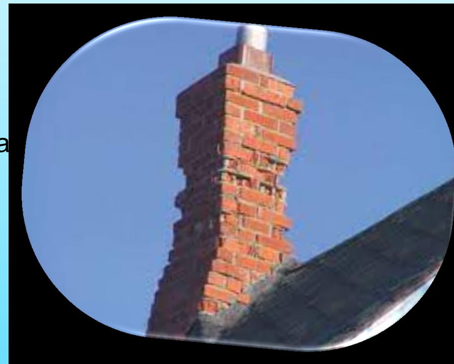
Špatný stav komína
