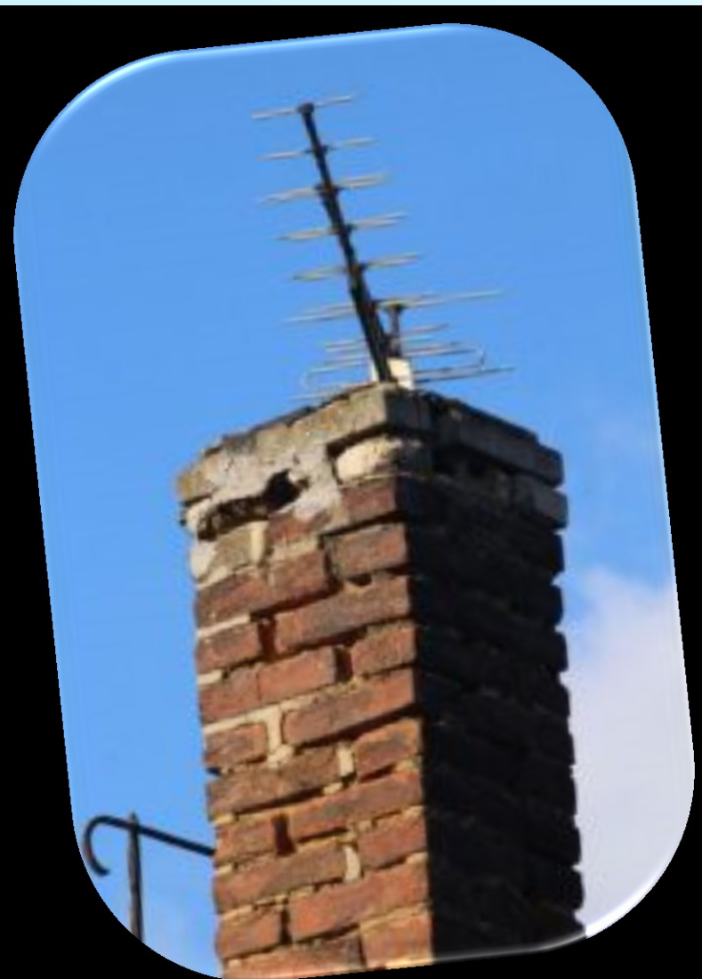
Špatný stav komína.
